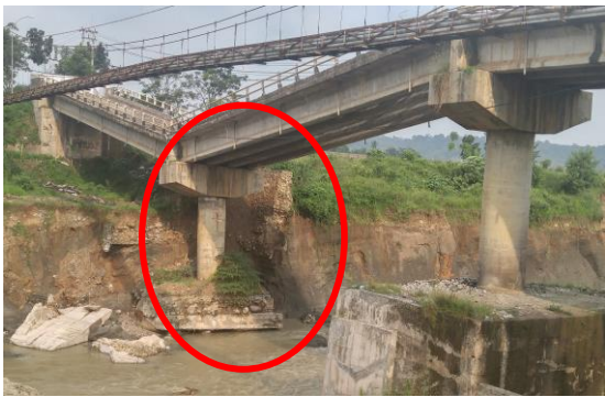
Gambar 1. Pilar jembatan Cipamingkis mengalami penurunan
